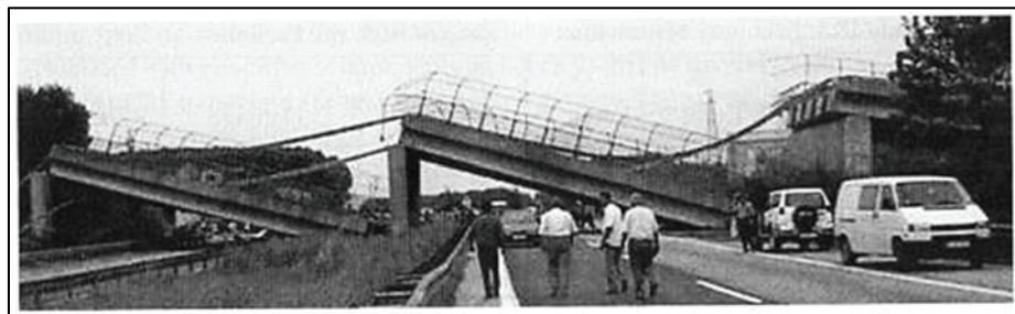
Figura I 31-2: Estado final del puente de la carretera Arifiye. (Fuente: Youd et al., 2000, figure 18.3)
