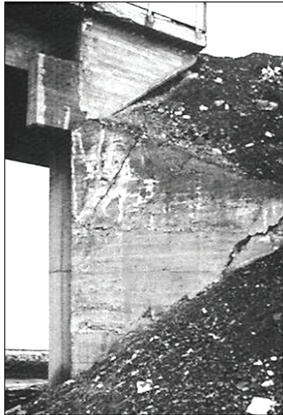
Figura I 27-2: Daños en los muros de acceso, pila derecha y pérdida de relleno de acceso del puente de la Figura I 27-1 (Fuente: Earthquake Spectra , July 1993, p. 123)
