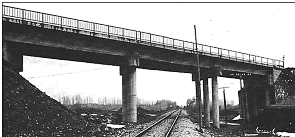
Figura I 27-1: Puente de la autopista a Kemah, sobre el ferrocarril Ankara-Kars. El acceso de la izquierda sufrió asentamientos por caída de material de relleno. El acceso de la derecha sufrió daños que se detallan en la Figura I 27-2 (Fuente: Earthquake Spectra , July 1993, p. 121)
