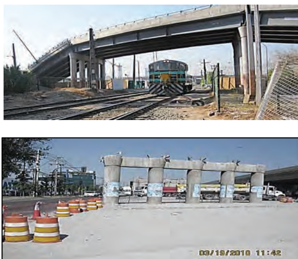
Figura I 35-7: Arriba: Lado izquierdo, se aprecia parte del puente caído por pérdida de apoyo. Abajo: Pórtico sin daños aparentes y sin vigas. (Fuente: : EERI/PEER/FHWA, 2010)
