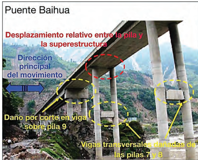
Figura I 34-4: Daños en la estructura portante del puente Baihua y desplazamiento del tablero (Fuente: Lee, 2008, 60/112)
