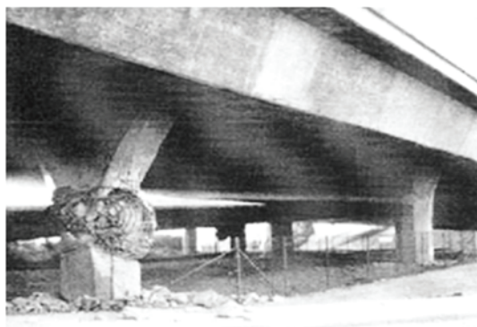
Figura II 7-4: Pandeo de acero principal, probablemente iniciada por una falla debido al elevado cortante en esa columna corta. (Fuente: EERI, 1995c, p. 318)
