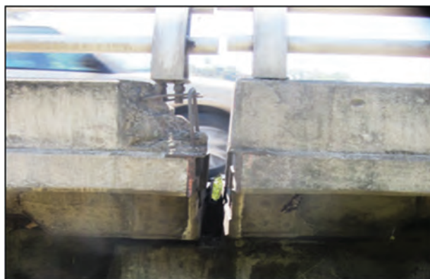
Figura I 38-4: Separación del tablero en el puente de la Figura I 38-3. (Fuente: Rollins et al., 2013)
