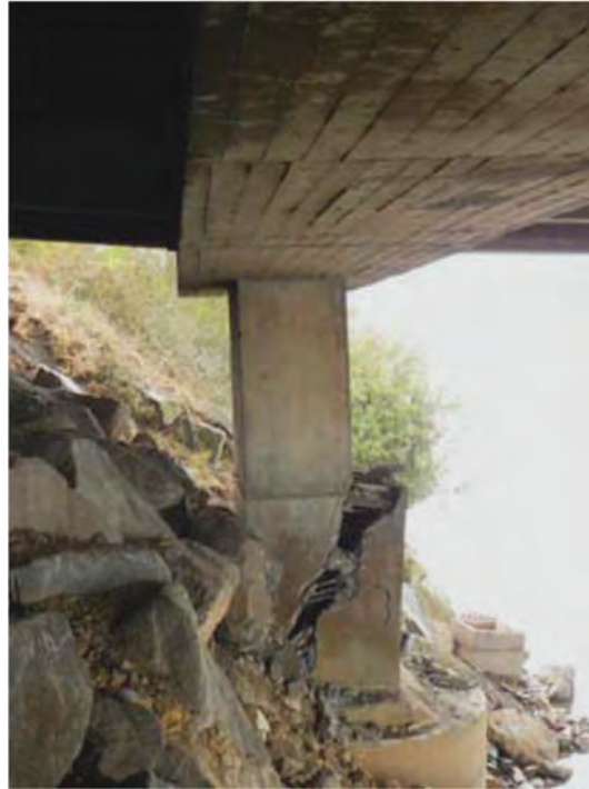
Figura I 35-3: Detalle de una columna fallada por corte en la entrada norte del Puente Juan Pablo II sobre el río Bio-Bio, Concepción, debido a desparramamiento lateral del terreno y movimiento de la superestructura en el tope de la columna (Foto: J. Arias. Fuente: EERI Special Earthquake Report — June 2010) https://www.eeri.org/site/images/eeri_newsletter/2010_pdf/Chile10_insert.pdf
