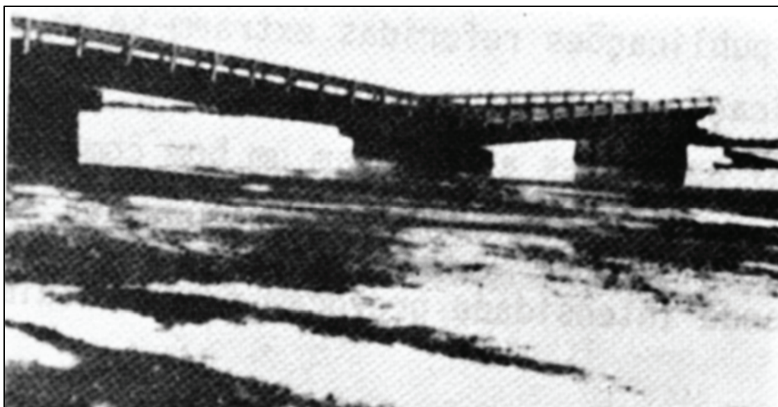
Figura I 6-4: Colapso del puente sobre el río Copper. Apparently las pilas centrales se asentaron. (Fuente: Martin, G.R. et al., 1979)
