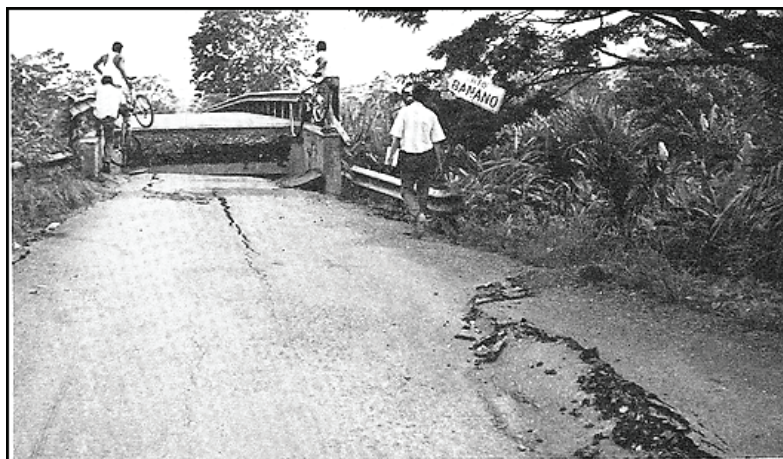
Figura I 26-7: Asentamientos del terreno en uno de los accesos al puente del río Banano. (Fuente: EQE, 1991, p. 11)
