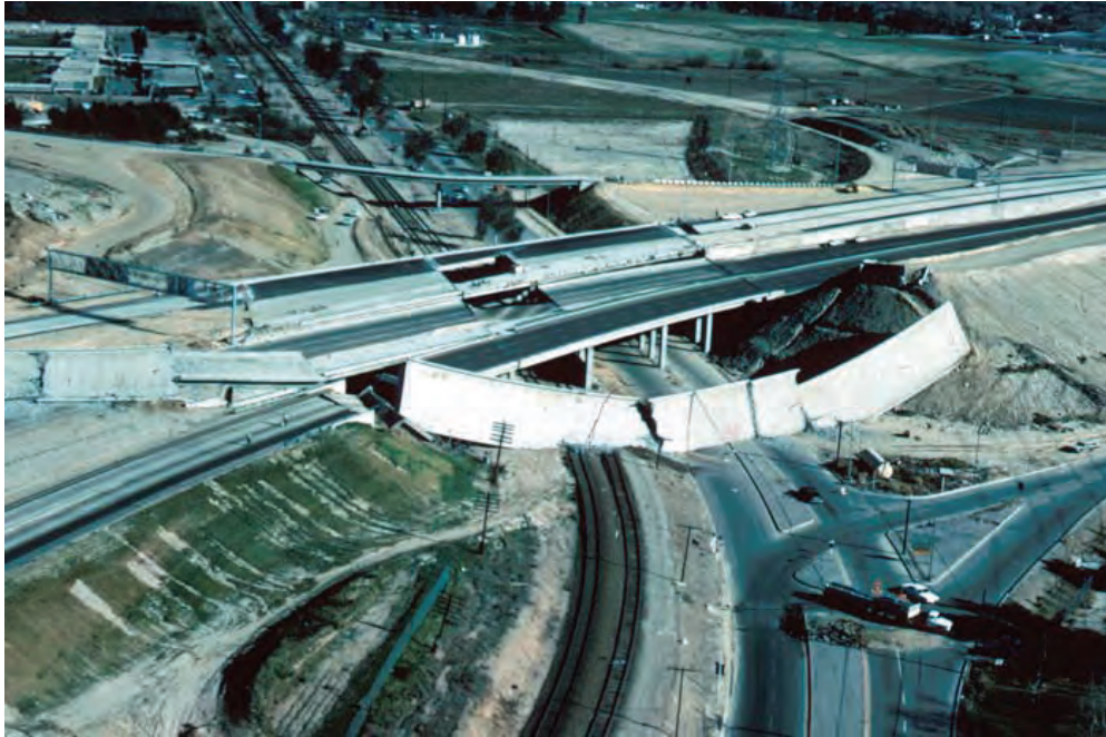
Figura I 9-2: Colapso del paso superior de la conexión de las autopistas Foothill y Golden State, en el área de San Fernando. La disrupción en el área es visible.(Fuente: Reuben Kachadoorian, USGS. https://commons.wikimedia.org/w/index.php?curid=20757919 )
