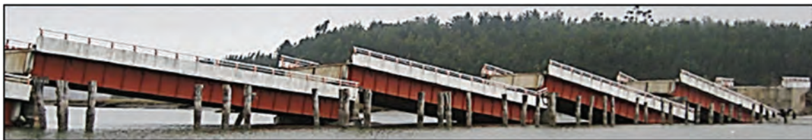
Figura I 35-5: Estado final del puente Tubul después del sismo de 2010. (Fuente: : EERI/PEER/FHWA, 2010)
