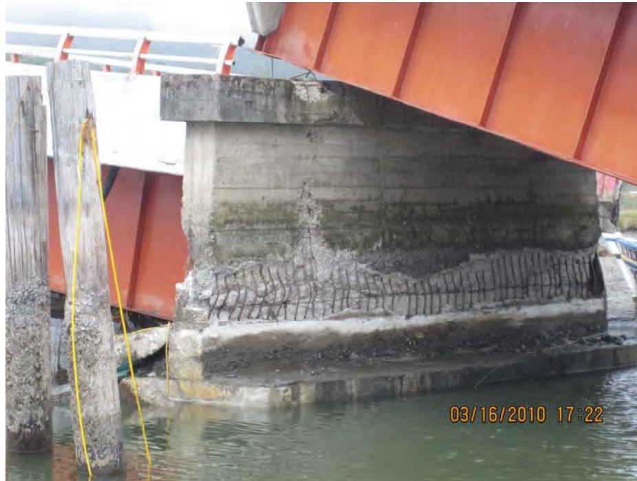
Figura I 35-4: Falla de una de las pilas de apoyo del puente Tubul el cual es el que está ubicado más al sur del área epicentral. (Fuente: EERI/PEER/FHWA, 2010)
