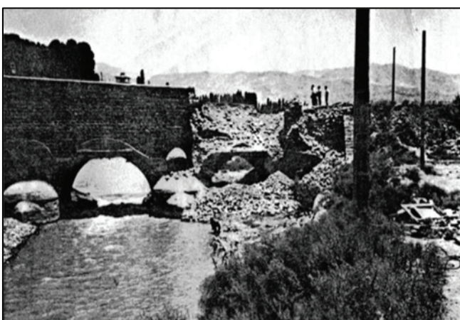
Figura I 25-1: Dos puentes de mampostería, con muchos años de servicio, afectados en el área de Loshan, Irán. (Fuente: IIEES, Irán, p. 33)
