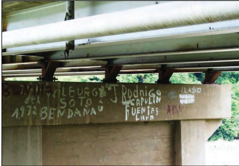
Figura I 38-2: Detalle de los pernos de fijación desprendidos en el puente de la Figura I 38-1. (Fuente: Rollins et al., 2013)
