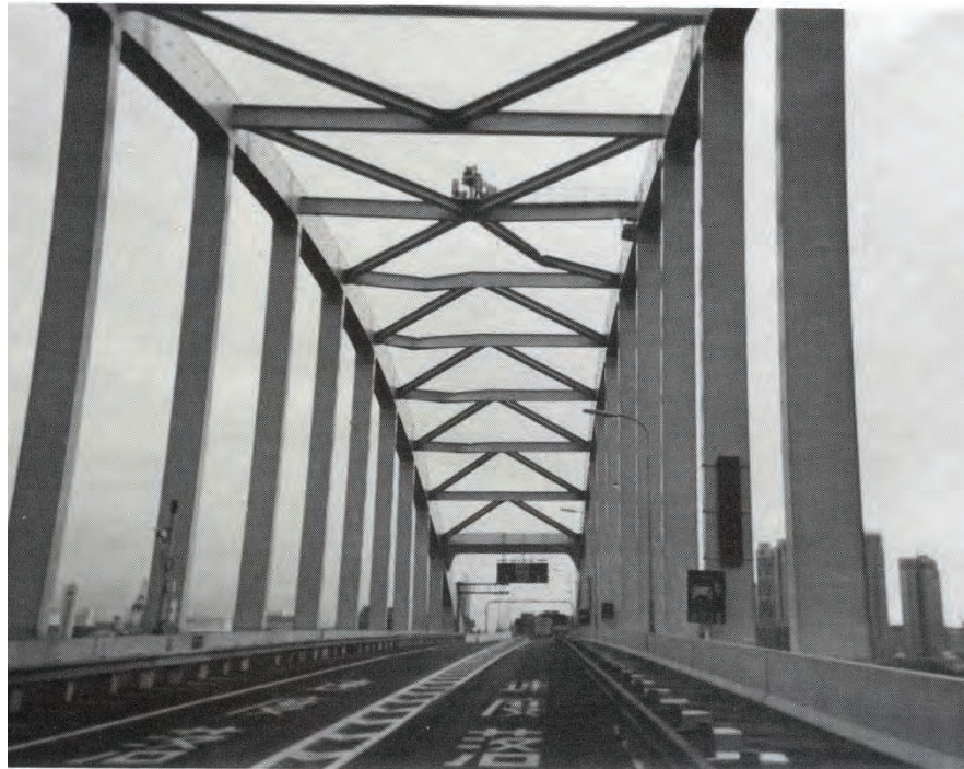
Figura I 30-21: Pandeo en el arriostamiento metálico de un puente hacia la Isla Rokko. (Fuente: EERI, 95-04, p. 57)
