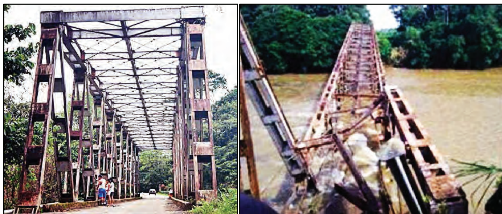
Figura I 38-9: Puente Sarapiquí-LaVirgen. A la izquierda antes del sismo. A la derecha estado final luego del sismo. (Fuente: Rollins et al., 2013)
