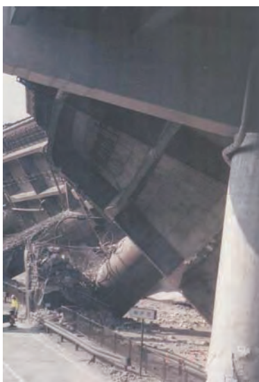
Figura I 30-13: Un estado más avanzado de daño, de una columna similar a la de la Figura I 30-12. (Fuente: EQE, 1995, p. 45)
