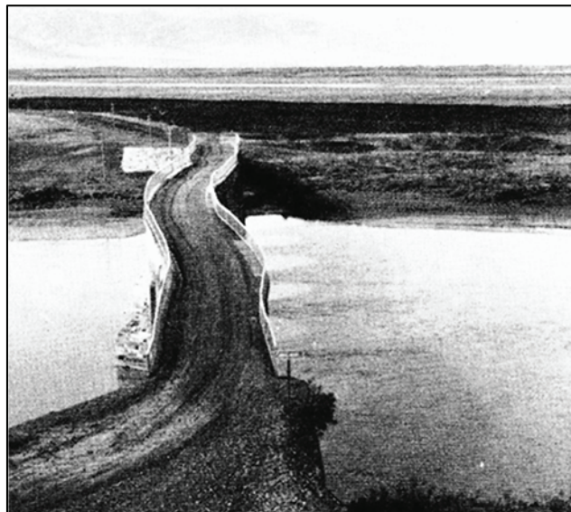
Figura I 8-1: Puente sobre el río Murat, Anatolia. Los informes de campo no revelaron daños atribuibles al sismo. (Fuente: Ambraseys and Zátópek, 1968, BSSA, p. 84)
