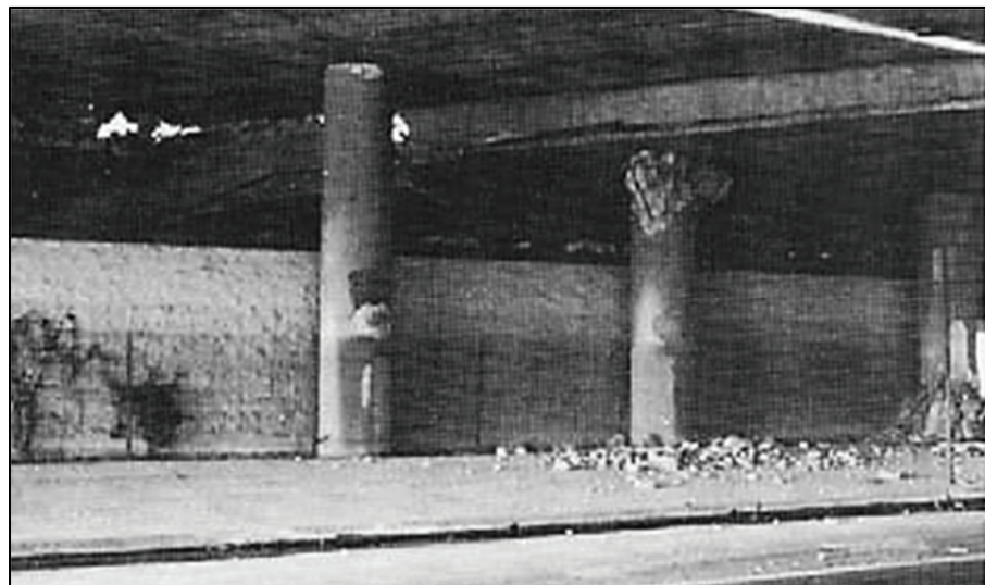
Figura I 29-9: Estado final de las columnas del pórtico 7 (B, C y D), en el cruce La Cienega-Venice. (Fuente: Earthquake Spectra, 1995, p. 335)
