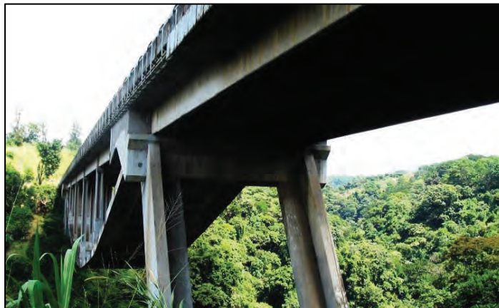
Figura I 38-7: Puente Rafael Iglesias sobre el río Colorado. Pequeños desplazamientos en el área de apoyo. (Fuente: Rollins et al., 2013)
