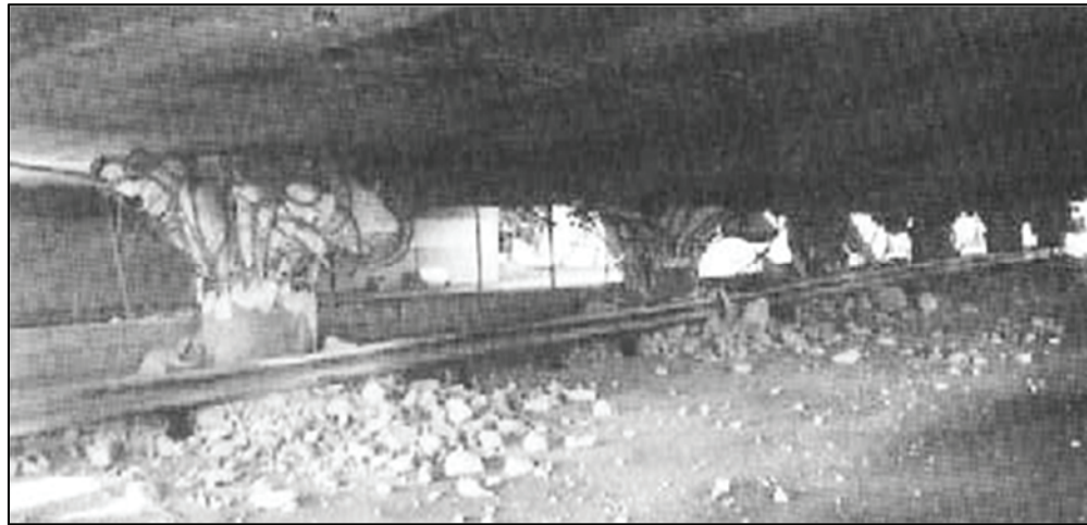
Figura I 29-12: Estado final de las columnas del pórtico 3 en el cruce inferior Fairfax-Washington. (Fuente: Earthquake Spectra, 1995, p. 339)
