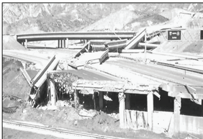
Figura I 9-1: Vista general de la afectación de puentes, algunos en ejecución. (Fuente: Lew et al., 1971)
