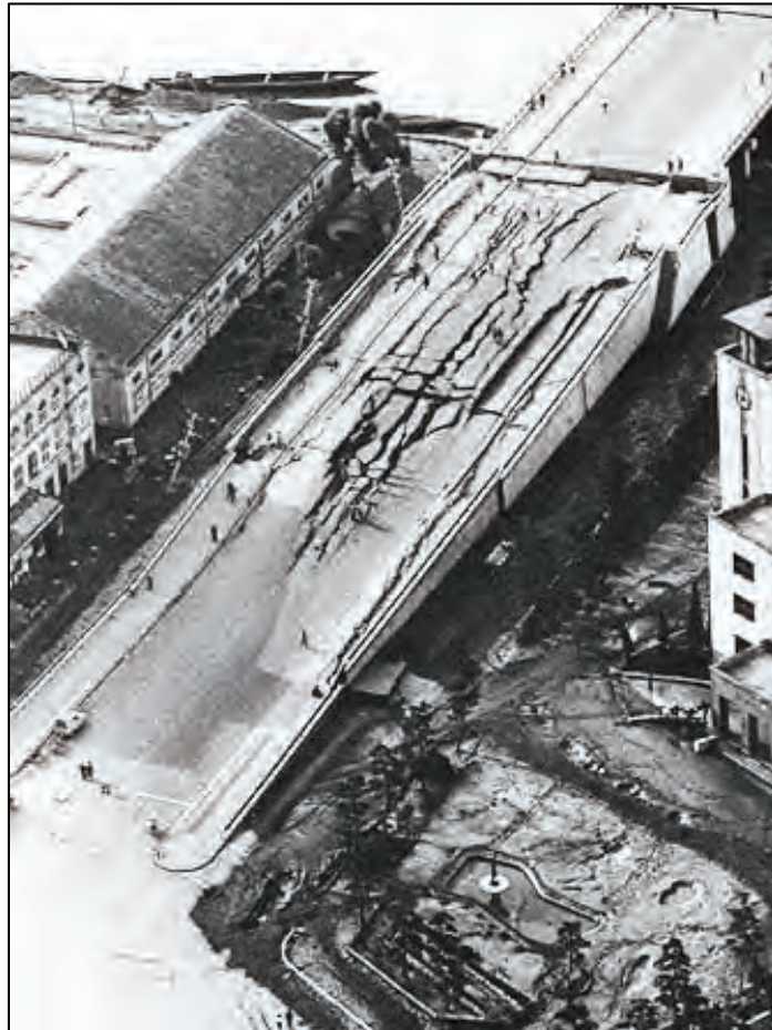
Figura I 7-2: Vista del acceso al puente Shōwa Shinano desde la ciudad de Niigata. El agrietamiento del tablero fue generado por la presión lateral del terreno licuado; los volcanes de arena adyacentes a la estructura, se observan a la derecha. (Fuente: Eiby, 1980, p. 126)
