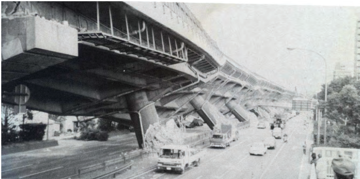
Figura I 30-7: Otra vista del volcamiento de la autopista Hanshin. (Fuente: EERI, 1995, fig. 4-9, p. 50)
