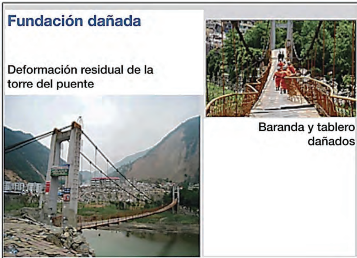
Figura I 34-8: Daños en puente colgante para peatones, por rotación de la torre izquierda del puente. (Fuente: Lee, 2008, p. 69/112)
