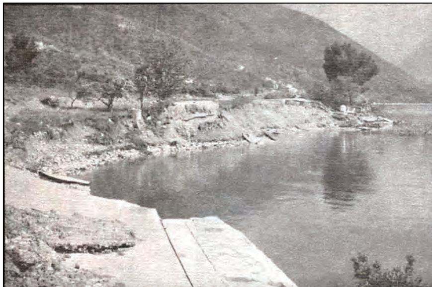
Figura I 15-2: Otra vista de derrumbes de la Autopista del Adriático. (Fuente: Leeds, 1980, editor, EERI, 1980, p. 22)
