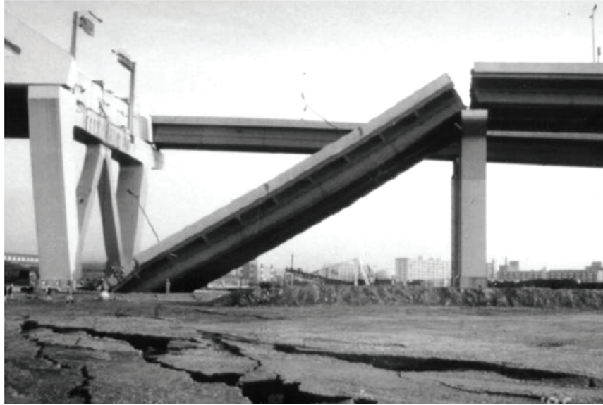
Figura I 30-20: Desplazamiento permanente del pórtico que dio origen a la pérdida del tramo de acceso al puente Nishinomiya-ko. (Fuente: Brando, M., 2010-2011)
