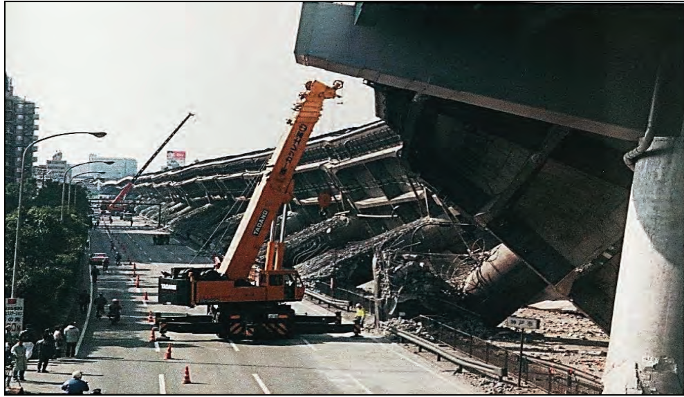
Figura I 30-6: Volcamiento de la autopista Hanshin, en la zona de las columnas de concreto. En otros tramos, columnas tubulares metálicas solo mostraron inicio de pandeo local. (Fuente: EQE, 1995, p. 45)
