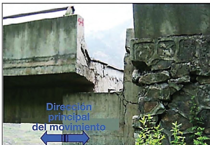
Figura I 34-7: Desplazamiento del tablero en la dirección perpendicular a la falla activa. (Fuente: Lee, 2008, p. 66/112)
