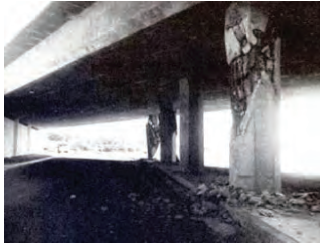
Figura I 9-5: Daños en las dos columnas extremas de las cuatro columnas del puente en esviaje Foothill Boulevard Undercrossing. (Fuente: EERI, 1986, Publicación 86-02, November, p. 99)
