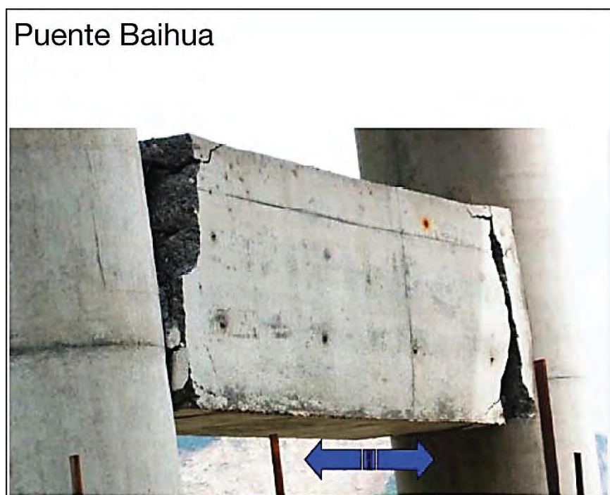
Figura I 34-6: Falla de una viga transversal de acoplamiento, aparentemente por insuficiencia de refuerzo. (Fuente: Lee, 2008, p. 63/112)
