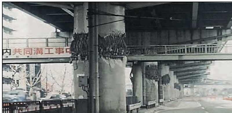
Figura I 30-3: Las fallas de estas columnas, ubicadas hacia la mitad de su altura, posiblemente fueron inducidas por fuerzas axiales importantes y escaso refuerzo de confinamiento. (Fuente: EQE, 1995, p. 48)
