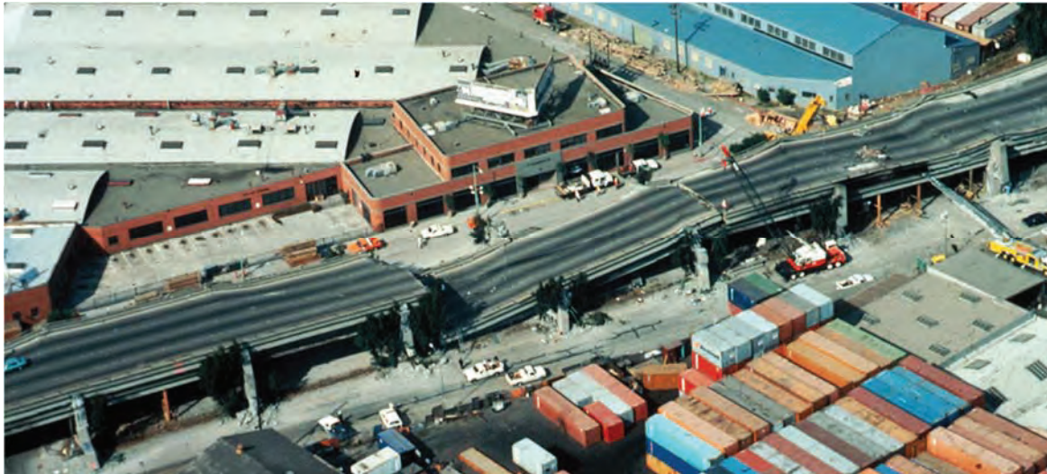
Figura I 24-4: Vista aérea de tramos de la Autopista Cypress Street Viaduct en Oakland, donde partes del Nivel 2 se desplomaron sobre el Nivel 1. (H.G. Wilshire, U.S. Geological Survey - Photo by H. G. Wilshire for U.S. Geological Survey). https://en.wikipedia.org/wiki/1989_Loma_Prieta_earthquake#/media/File:Cypress_structure.jpeg
