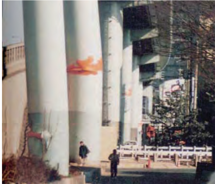
Figura I 30-4: Transeúntes circulan por las inmediaciones de la autopista con daños estructurales vulnerables a una réplica. (Fuente: EQE, 1995, p. 49)
