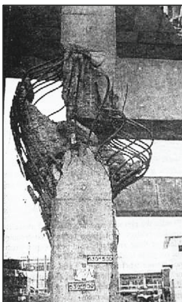
Figura I 30-17: Falta de confinamiento en nodos de la estructura del tren bala (Shinkansen Line). (Fuente: Park et al., 1995, p. 62)
