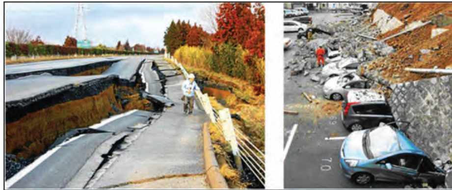
Figura I 36-2: Fallas en el talud de un terraplén y falla de un muro de contención. (Fuente: Informe Tokai University)
