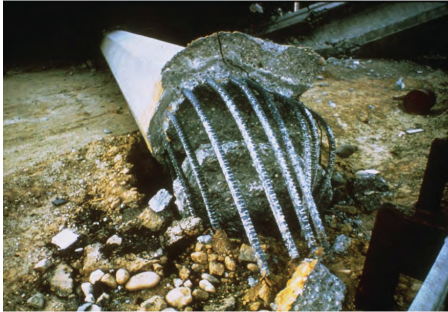
Figura I 9-6: Columna arrancada de su base en el distribuidor 5/210, California (NOAA/NGDC, E.V. Leyendecker, U.S. Geological Survey).
