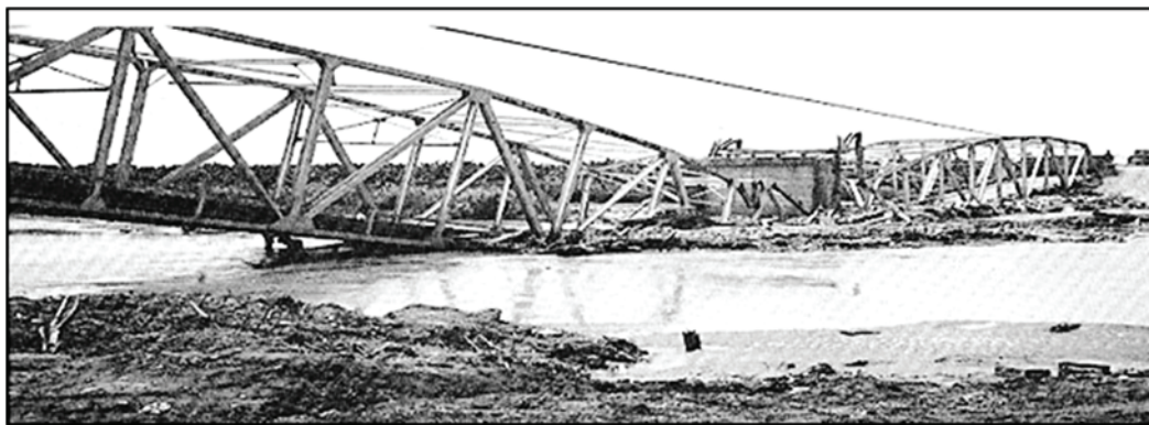
Figura I 26-6: Estado final del puente sobre el río Estrella. (Fuente; EERI, 1991, p.83)
