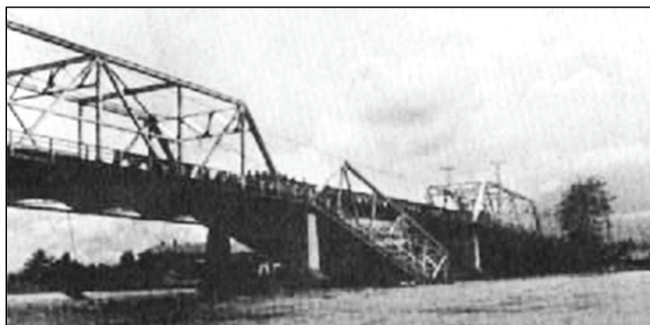
Figura I 14-1: Falla parcial en el puente Quirino de cuatro tramos. (Fuente: EERI, 1977, p. 75)
