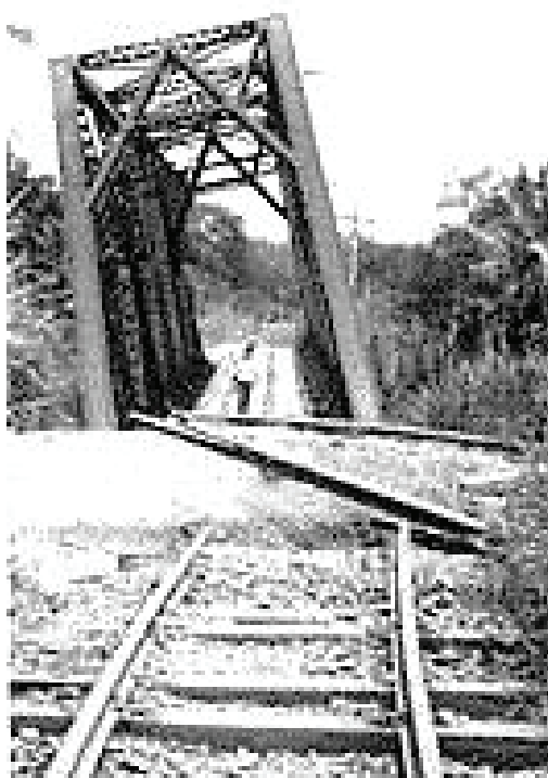
Figura I 26-8: Puente ferroviario sobre el río Bananito. Volcamiento de estribos y desprendimiento de apoyos. (Fuente: https://nisee.berkeley.edu/elibrary/files/thumbnail/EERC_2006_0820/IMG2601.jpg )
