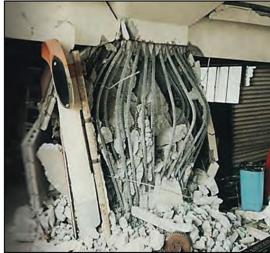
Figura I 30-14: Esta columna prácticamente sin acero de confinamiento, soportaba una parte de la estación de tren Rokkomichi. (Fuente: EQE, 1995, p. 57)
