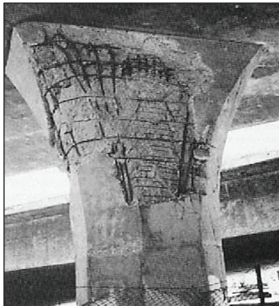
Figura I 29-3: Falla por corte y flexión de la columna con ensanchamiento, en el cruce inferior Mission-Gothic. (Fuente: Earthquake Spectra, 1995, p. 319)
