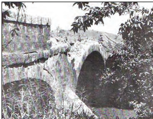
Figura I 11-1: Puente de Creekside Road bridge, 2 km al suroeste de Saint Johns, fue cerrado al tráfico debido a que la estructura de mampostería perdió algunas de sus piezas. (Fuente: Tomblin and Aspinall, 1975, p. 156)
