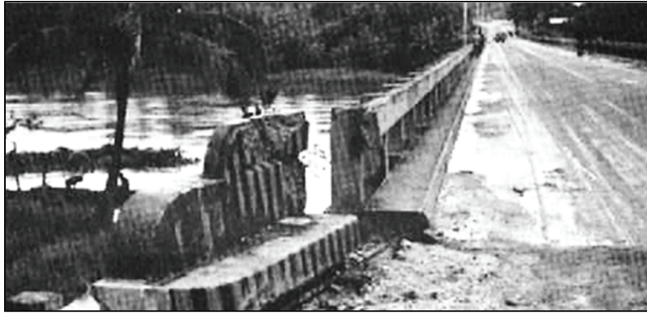
Figura I 14-2: Desplazamiento permanente del puente Tamontaka. (Fuente: EERI, 1977, p. 79)
