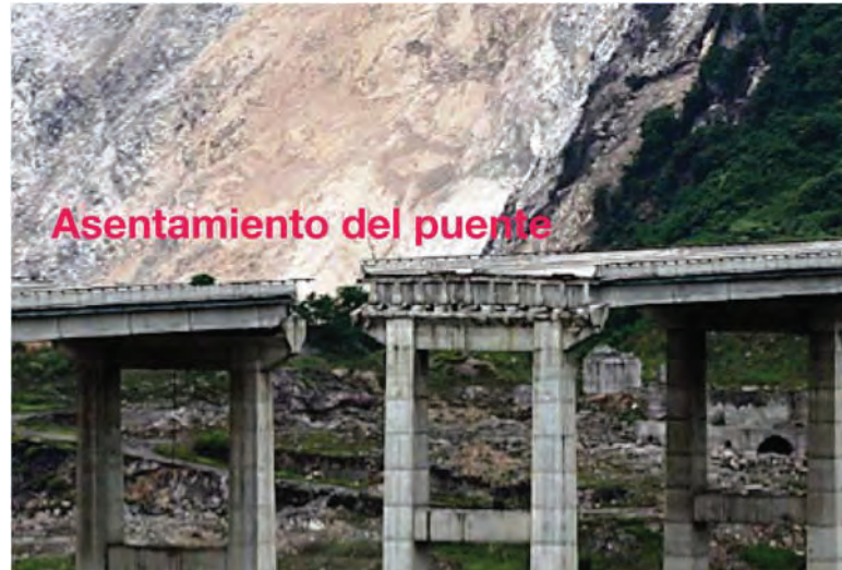
Figura I 34-9: Un tramo del Tablero del puente del Condado de Wenchuan perdió su apoyo por falta de continuidad de sus miembros. (Fuente: Lee, 2008, p. 71/112)
