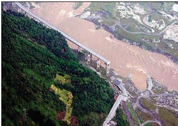
Figura I 34-3: Ruina de cuatro vanos del puente Baihua en el área de la falla tectónica. (Fuente: Lee, 2008, 58/112)
