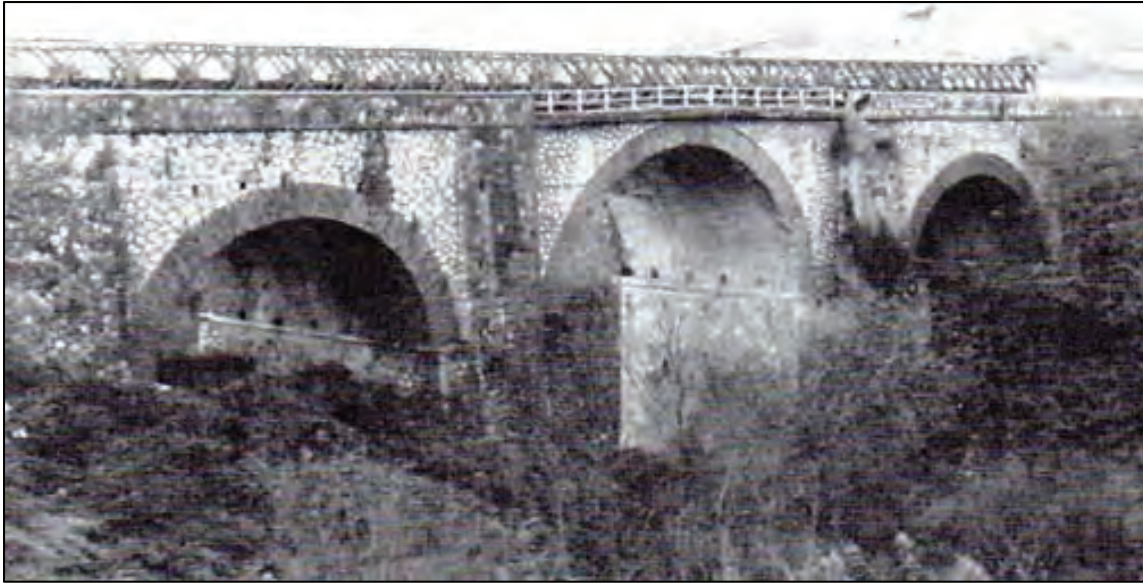
Figura I 18-3: Asentamiento en una de las pilas del puente de Sant'Angelo dei Lombardi. Obsérvese el Puente de Guerra. (Fuente: Strata et al., 1981, p. 33)
