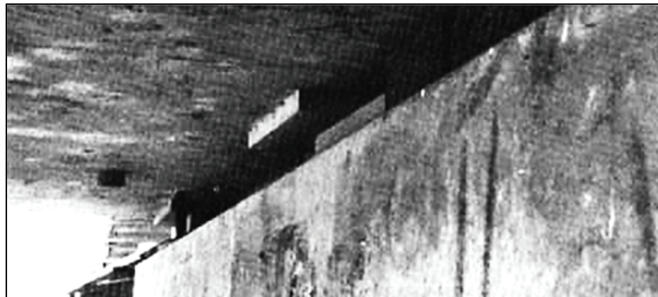
Figura I 14-3: Desplazamiento de las planchas de apoyo del puente Tamontaka. (Fuente: EERI, 1977, p. 81)
