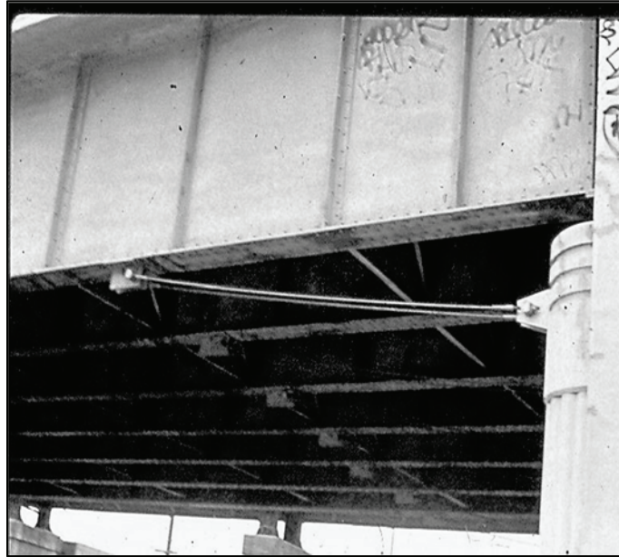
Figura I 29-15: Cada una de las siete vigas metálicas que conforman el tablero, quedó vinculada a las pilas de apoyo por medio de cables metálicos con tolerancia para deformaciones por temperatura. (Fuente: propia)
