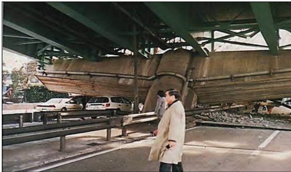
Figura I 30-5: Posiblemente esta falla haya sido por solicitaciones generadas sobre la monocolumna, consecuencia de una aparente altura menor que las demás con predominio de fracturas por corte. (Fuente: EQE, 1995, p. 47)
