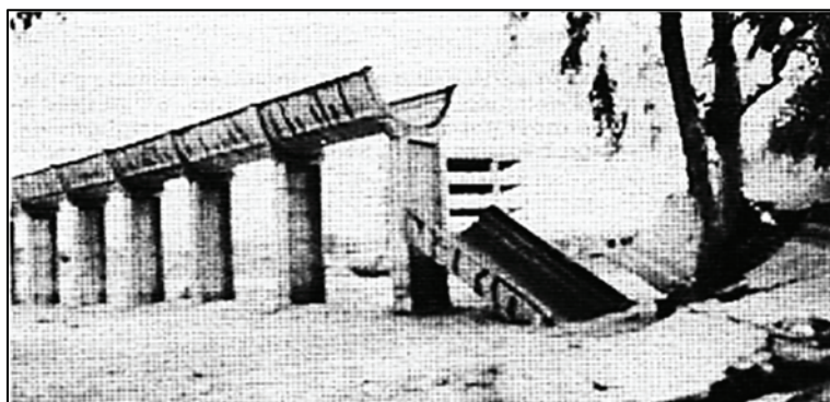
Figura I 17-3: Falla de un canal de sección semicircular, para agua de regadío. (Fuente: Bertero and Shah, 1983, p. 3-35)
