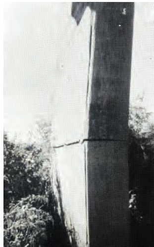
Figura I 20-7: Puente Lolenco. Agrietamiento de pilas y daños en mesas extremas de apoyo. (Fuente: Monge, 1986, fig. 12.19 y 12.20)
