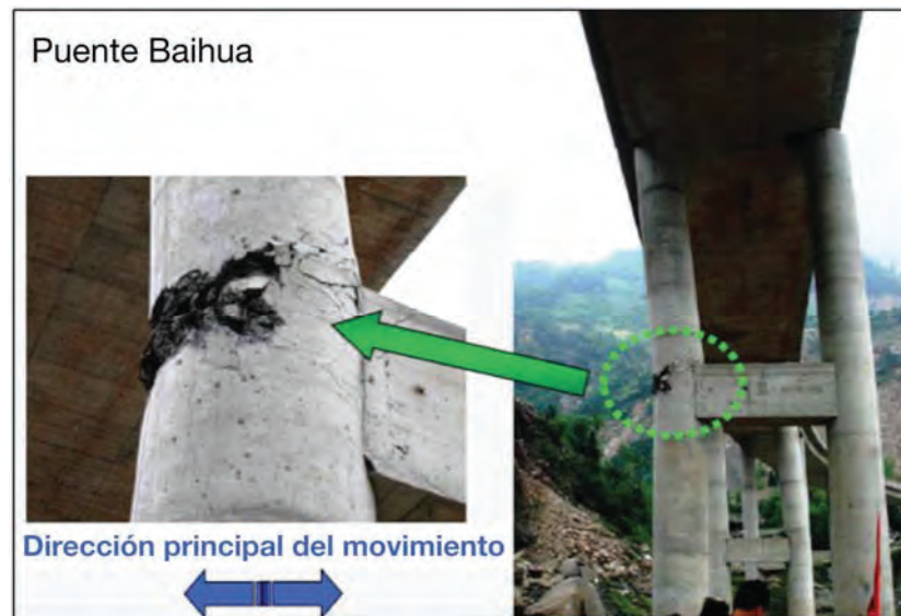
Figura I 34-5: Daños en una columna de concreto armado. Obsérvese el desplazamiento del tablero en el tope de la columna adyacente. (Fuente: Lee, 2008, p. 62/112)
