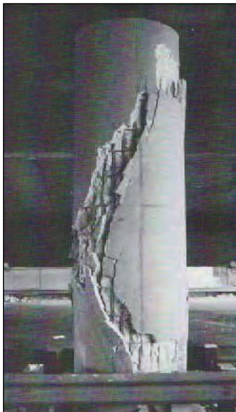
Figura I 29-13: Falla por flexión/corte en columna del pórtico 4 en el cruce inferior Fairfax-Washington. (Fuente: Earthquake Spectra, 1995, p. 340)
