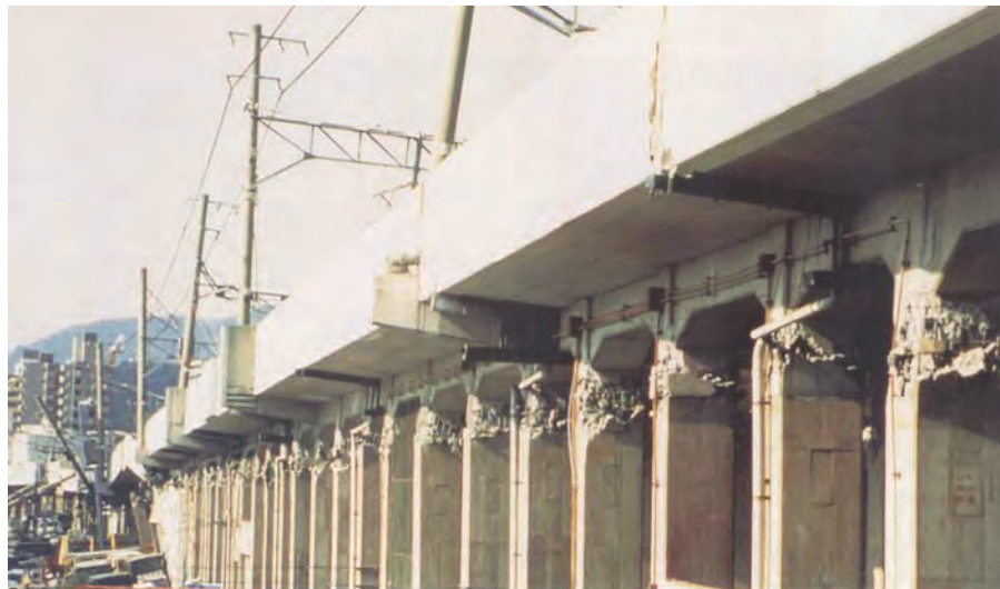
Figura I 30-15: Eficientes sistemas de prevención detuvieron el tren bala (Shinkansen) antes de alcanzar esta zona fuertemente deformada. La estructura presentó fallas por esfuerzo cortante. (Fuente: EQE, 1995, p. 58)
