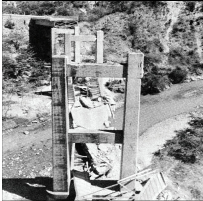
Figura I 12-6: Detalle del Puente Agua Caliente. Las longitudes de apoyo de los tableros fueron insuficientes y no hubo continuidad entre ellos. (Fuente: Castano y Zamarbide, 1976, p. 41)
