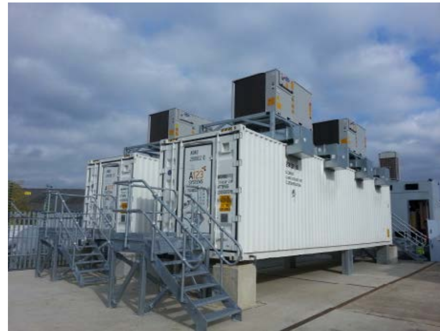
Figura 3. Sistema de almacenamiento de energía con baterías industriales con capacidad de 5 MWh. 5
